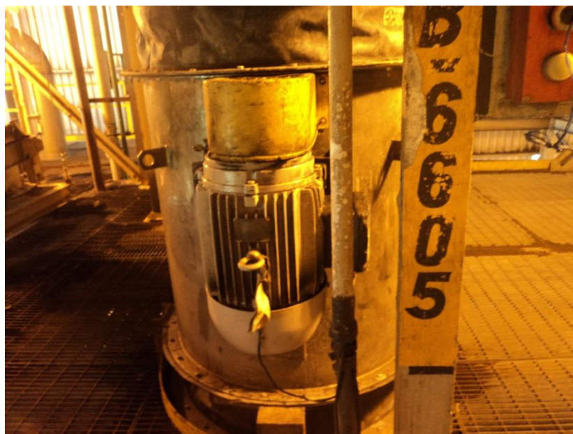
Figura 2 – Soprador axial de ar B-6605
